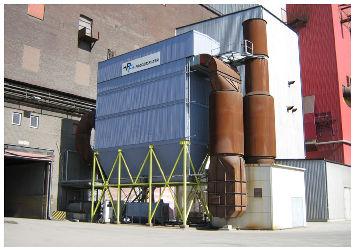
Bilden visar en anläggning som motsvarar de anläggningar på totalt 350 000 m 3 /h vi kommer att leverera till Volvo Powertrain.
